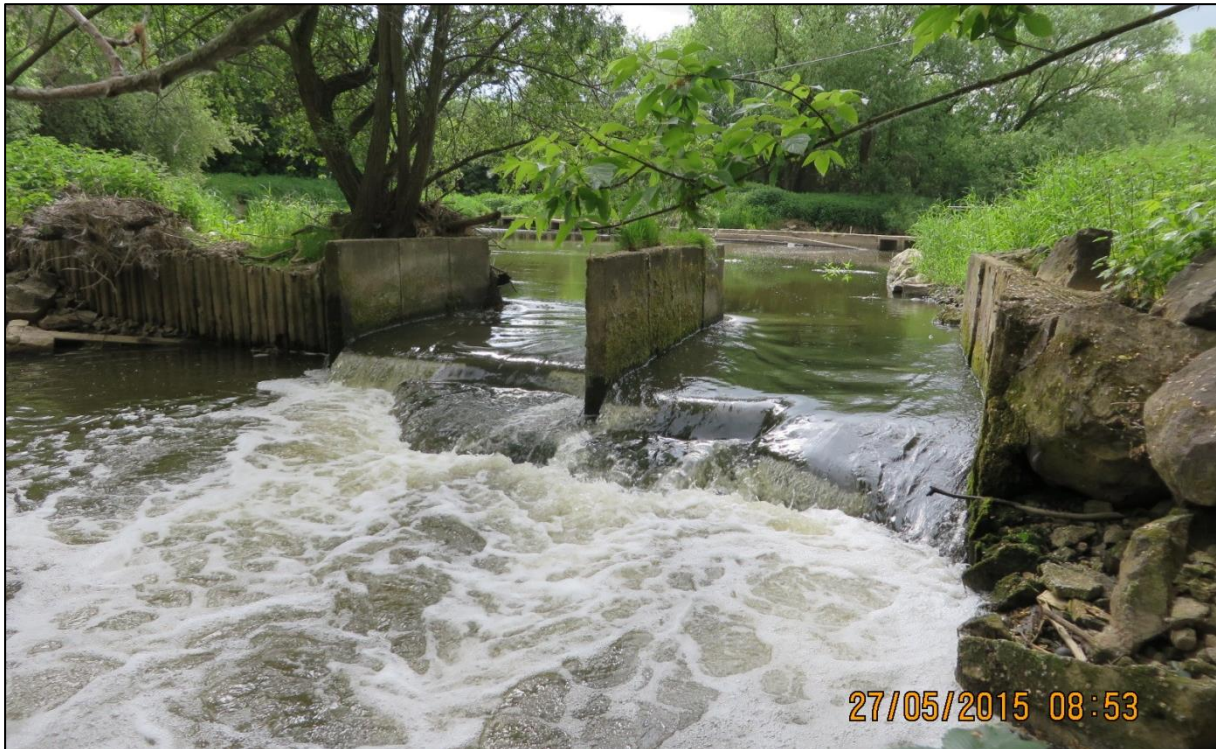
Abb. 3: Wehranlage an der Steinlache/Gerwische/Stilles Wasser, Aufnahme datum: 27.05.2015
